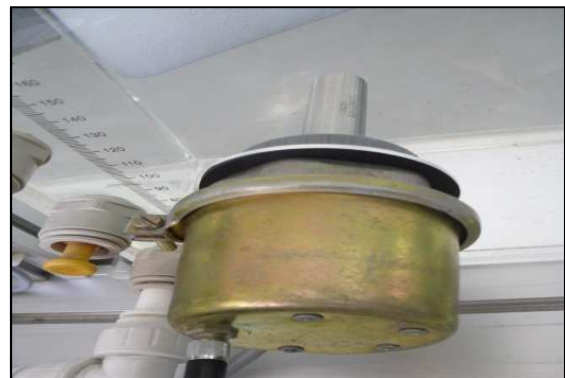
Fig. 3 Unidad de calefacción
