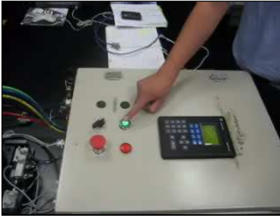
Figura 9: Vista exterior del gabinete del sistema Probador de Perillas, resaltando: La interfaz HMI Panel View, botones y paro de emergencia.
