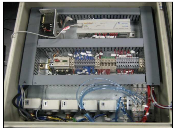
Figura 4: Elementos internos en el gabinete del sistema Probador de Perillas, resaltando: El PLC, fuente de voltaje de CD, presostátos, electroválvulas, clemas, fusibles, conductores eléctricos, canaleta, interruptor, manguera neumática, cable de comunicación y platina.
