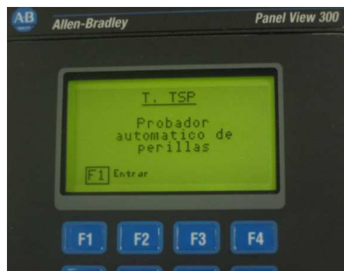
Figura 8: Pantalla 1 (principal) de la interfaz hombre-máquina que se instaló como parte del sistema.
