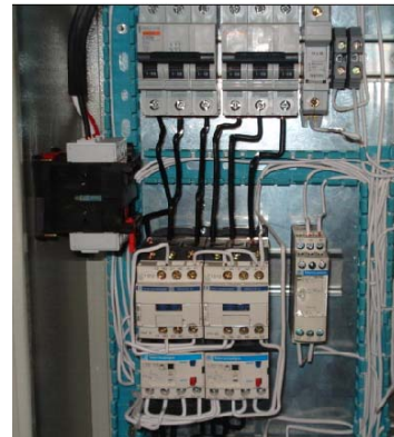
Fig. 9. Sistema eléctrico instalado en planta
